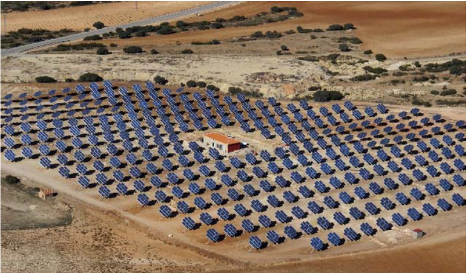
Champs de panneaux photovoltaïques
