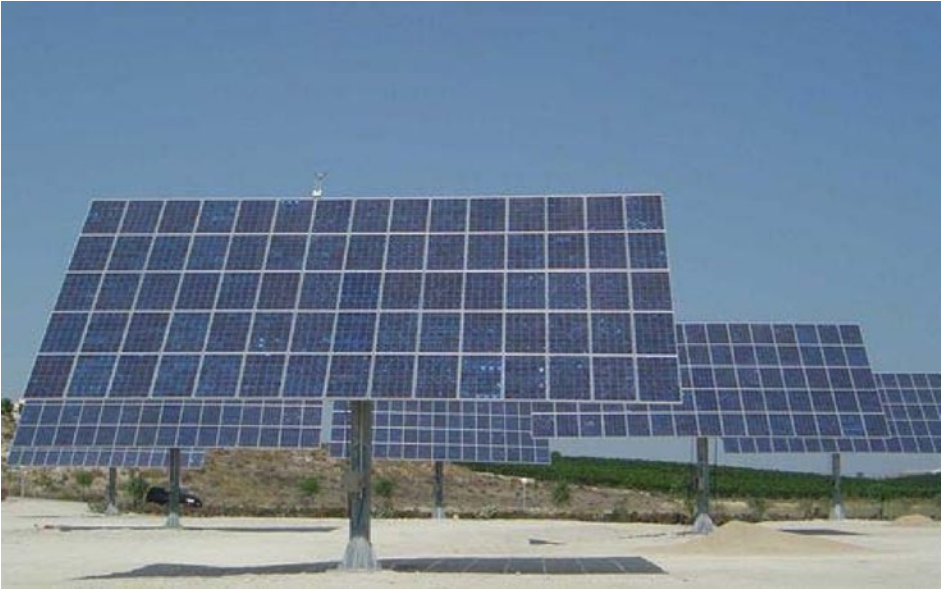
Panneaux photovoltaïques orientés
