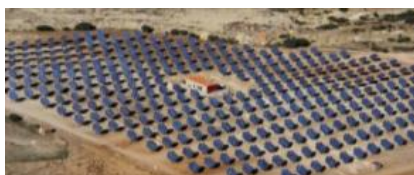
Champs de panneaux photovoltaïques
